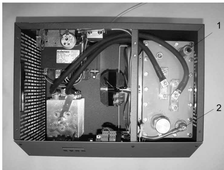
Abb. 3: Lötstar 175 Ansicht von oben ohne Gehäusedeckel 1 – Ausgang zum Oberteil: Kunststoff-Verschlussmutter entfernt 2 – Kunststoff-Verschlussmutter entfernt und Messanschluss montiert
